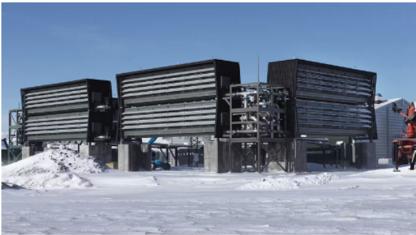
KOHLENSTOFFABSCHIEDUNG: Eine Climeworks-Anlage in Island.
